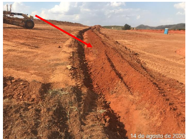
Foto 82 – Canaletas e leiras para direcionamento da água pluvial. (Data: 14/08/2020)
