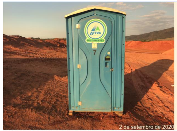
Foto 96 – Banheiro químico utilizado na obra. (Data: 02/09/19)
