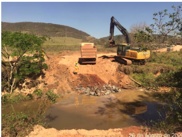
Foto 108 – Movimentação de material para implantação da Passagem molhada sobre o rio Camanducaia (Data: 26/08/2020)
