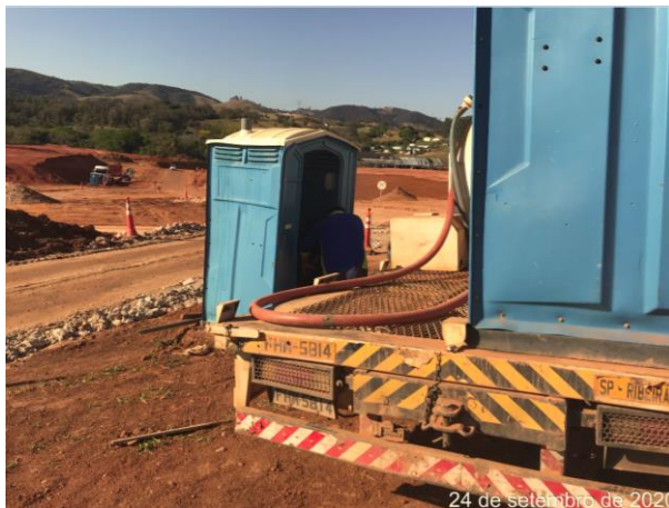
Foto 95 – Equipe realizando limpeza do banheiro químico. (Data: 24/09/19)
