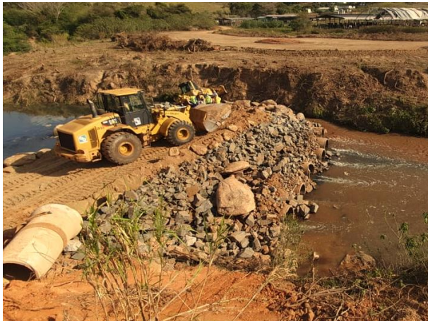
Foto 110 – Movimentação de material para implantação da Passagem molhada sobre o rio Camanducaia (Data: 31/08/2020)
